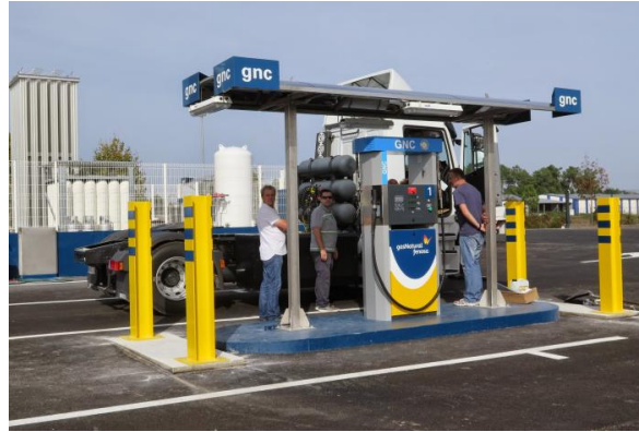
Station GNC à Digoïn
