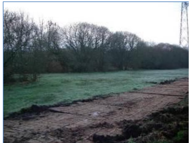
Figure 24 : Exemple d'un cheminement provisoire en bois qui protège le sol de la parcelle (bassin du Rion, chantier ERDF)
